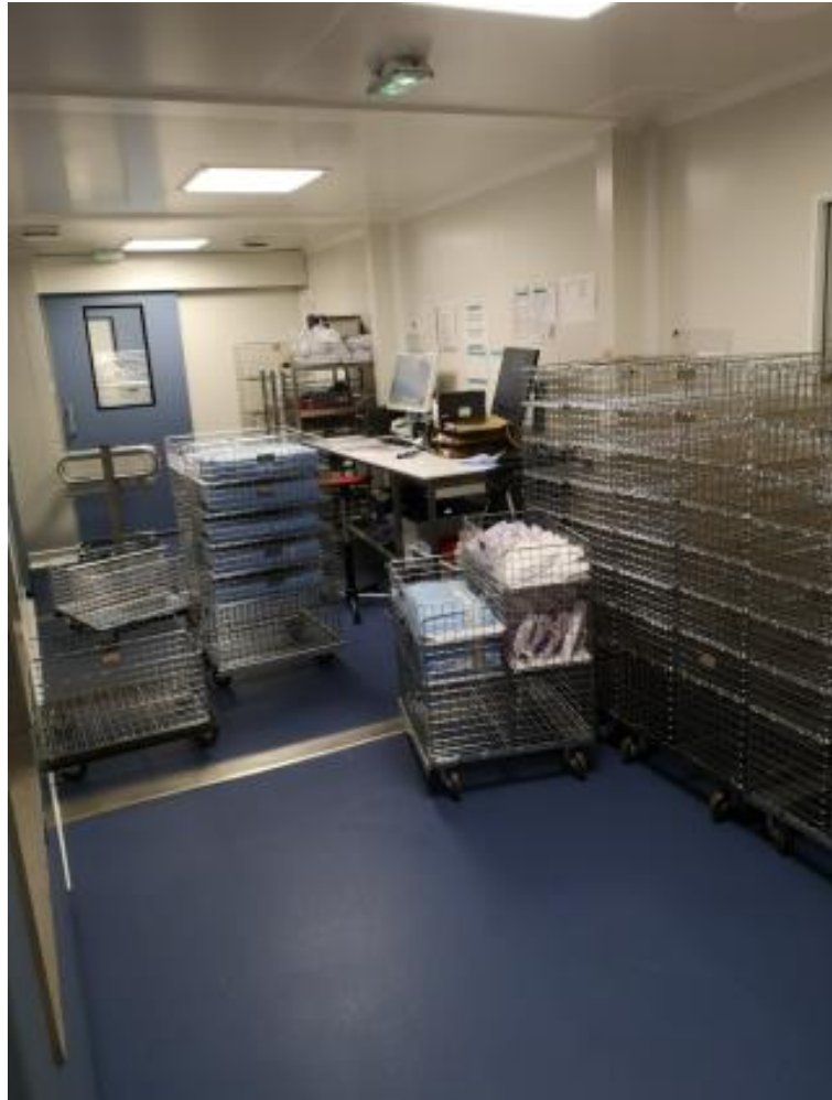
Zone de déchargement des autoclaves
